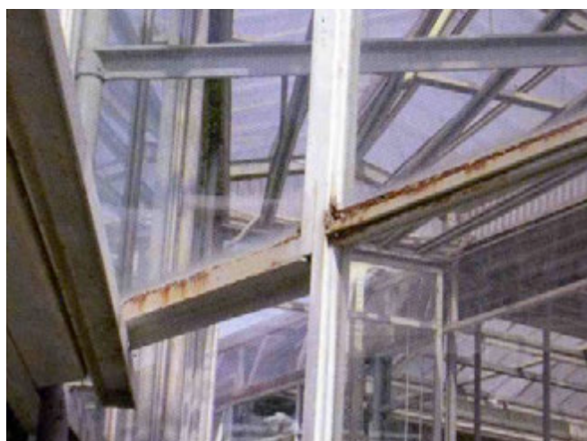
FIG. 6 - Stato di corrosione dei profilati metallici delle coperture di F. Minissi (foto d.A.)
